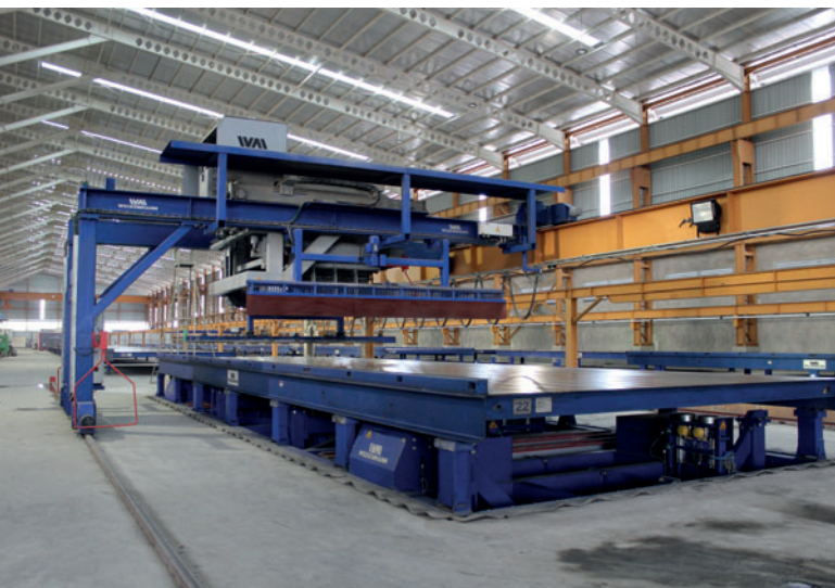
Distribuidor de concreto em concepção de semipórtico com paletes de forma e estação de adensamento
