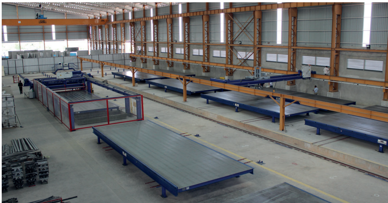
Instalação de circulação de plataforma deslizante central
