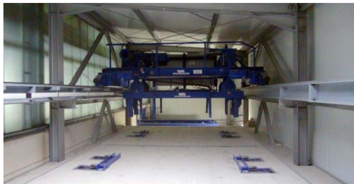
Вид на новую пропарочную камеру с полностью автоматическим краном-штабелером
