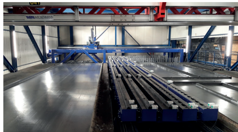
После модернизации: опалубочный участок с новыми тактовыми рольгангами и новым накопителем Weckenmann
